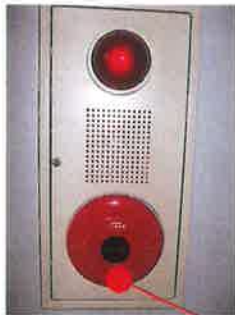
非常ベル (非常通報装置)
