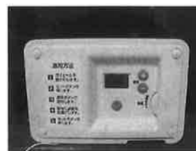
地震速報機 (事務室、地域交流室、 厨房に設置)
